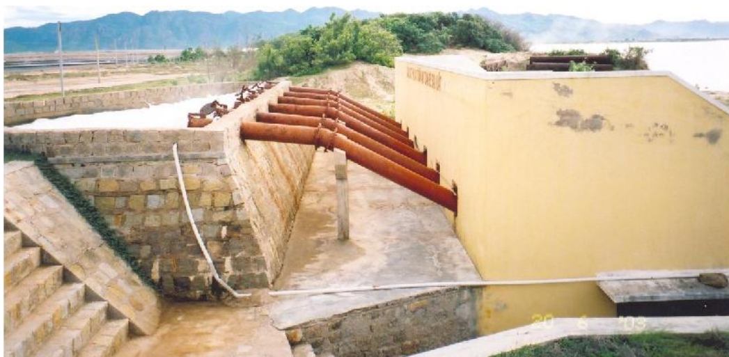
Hình 1.4: Cổng, trạm bơm lấy nước biển phục vụ sản xuất muối
