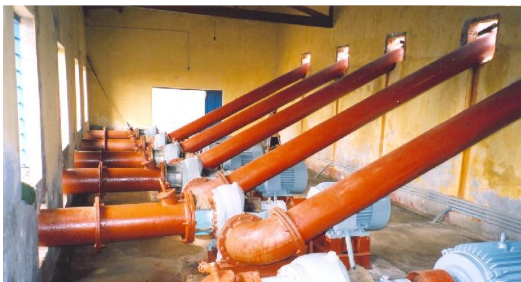
Hình 1.5: Trạm bơm lấy nước biển phục vụ sản xuất muối
